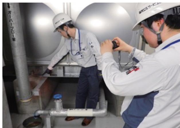
緊急施設・設備点検訓練の様子。点検者は2人一組でチェックリストに沿って点検実施。移動にエレベーターは使わない。
